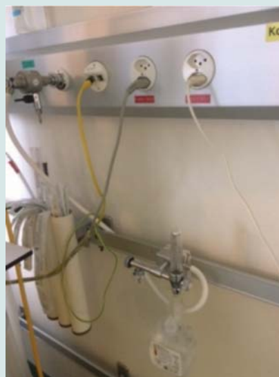
Druckluftspender oben, Sauerstoffspender unten montiert
